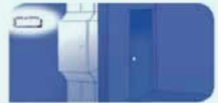
Cuadros de distribución de alumbrado
