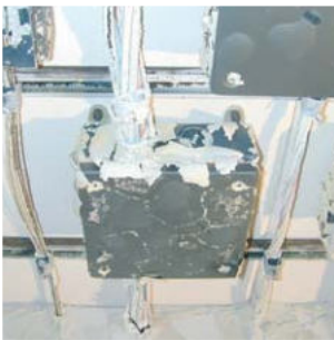
Caixa de derivação com cabos ligados após teste
